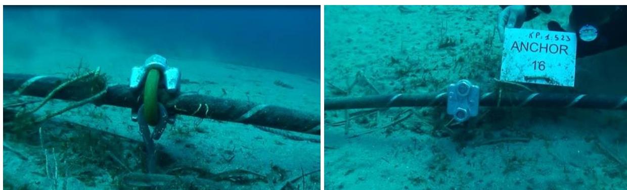
Figure 38 : Autre système de fixation du câble à l'ancre visant à limiter le risque de croche de l'ancre dans les filets de pêche (Orange Marine)
