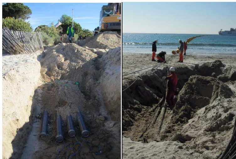
Figure 18 : Illustration de l'installation de conduites d'accueil en haut de plage (à gauche), puis de conduites dégagées à l'occasion de travaux préparatoires à la réception d'un câble (à droite)
