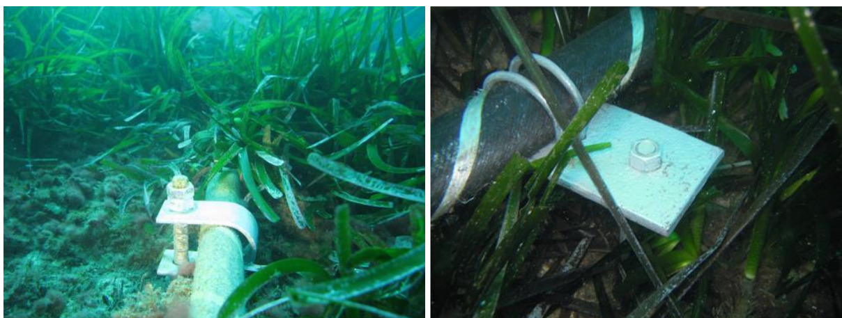
Figure 37 : Deux systèmes de fixation d'ancres à vis installées en zone d'herbier (photo : setec in vivo)
