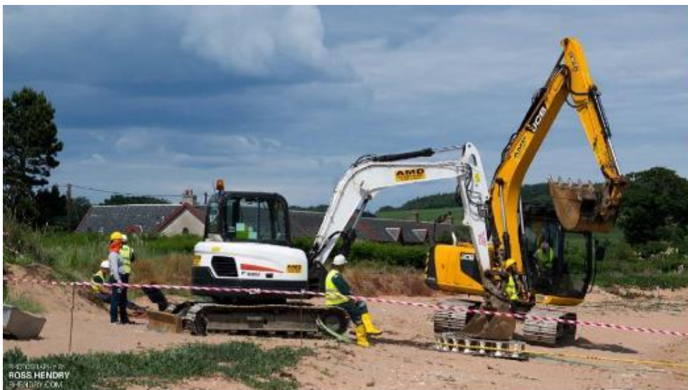
Figure 27 : Opération de tirage de câble avec deux pelleteuses et un quadrant (source : Orange Marine)
